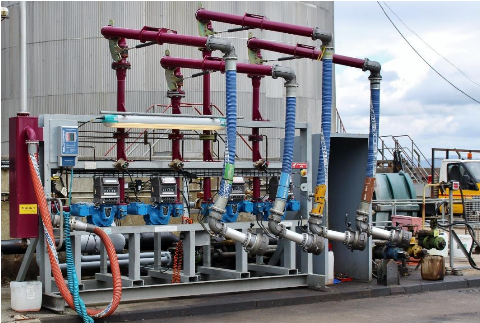
Multiple loading arms Múltiples brazos de carga
